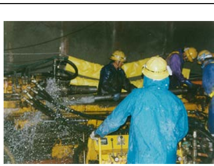
【図 2.1 トンネル工事での先進ボーリングから噴出する地下水】
