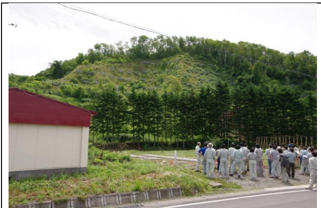
写真8 古丹別神社斜面崩壊
